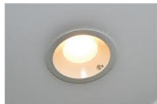
LED照明 スタイリッシュな上、長寿命で省エネにもなるLED照明を採用しました。
